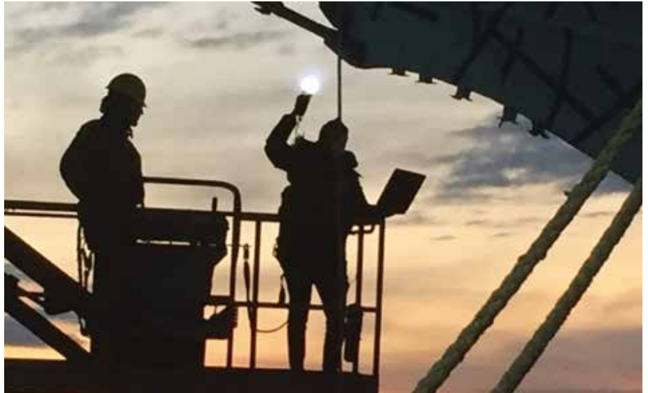
在三维激光扫描在户外进行时,可能需要在黎明或黄昏时分工作,因为有些扫描仪在阳光直射下不能正常工作。
